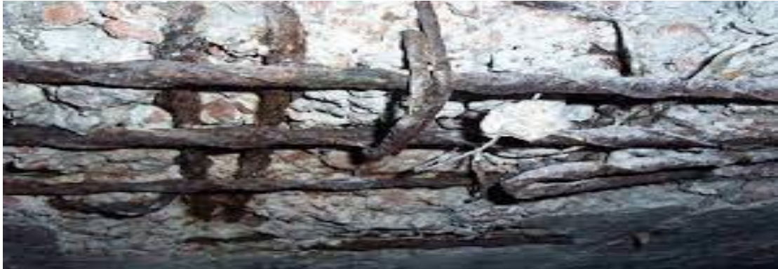
Figura 1: Deterioro del concreto por la acción de la humedad y el calor “cáncer de concreto.”
